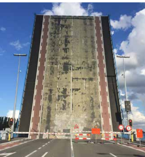
De Zelzatebrug, die ook voor doorgaand ADR-vrachtverkeer wordt gebruikt, zag er na tal van kleinere reparaties uit als een lappendeken.
