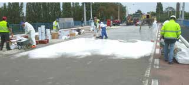
Een POLYAC®55 slijtlaag werd aangebracht, waarvan het antislip-effect werd gecreëerd door korundgranulaat in de slijtlaag te strooien.
